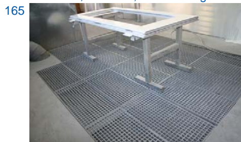
Lackierkabine , Absaugung, Filter, Heizung, Bj. 99 (Inbetriebnahme 2000)
